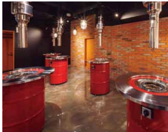
■ 奥側ホール ドラム缶テーブル席には強力な排煙ダクトが設置されています
